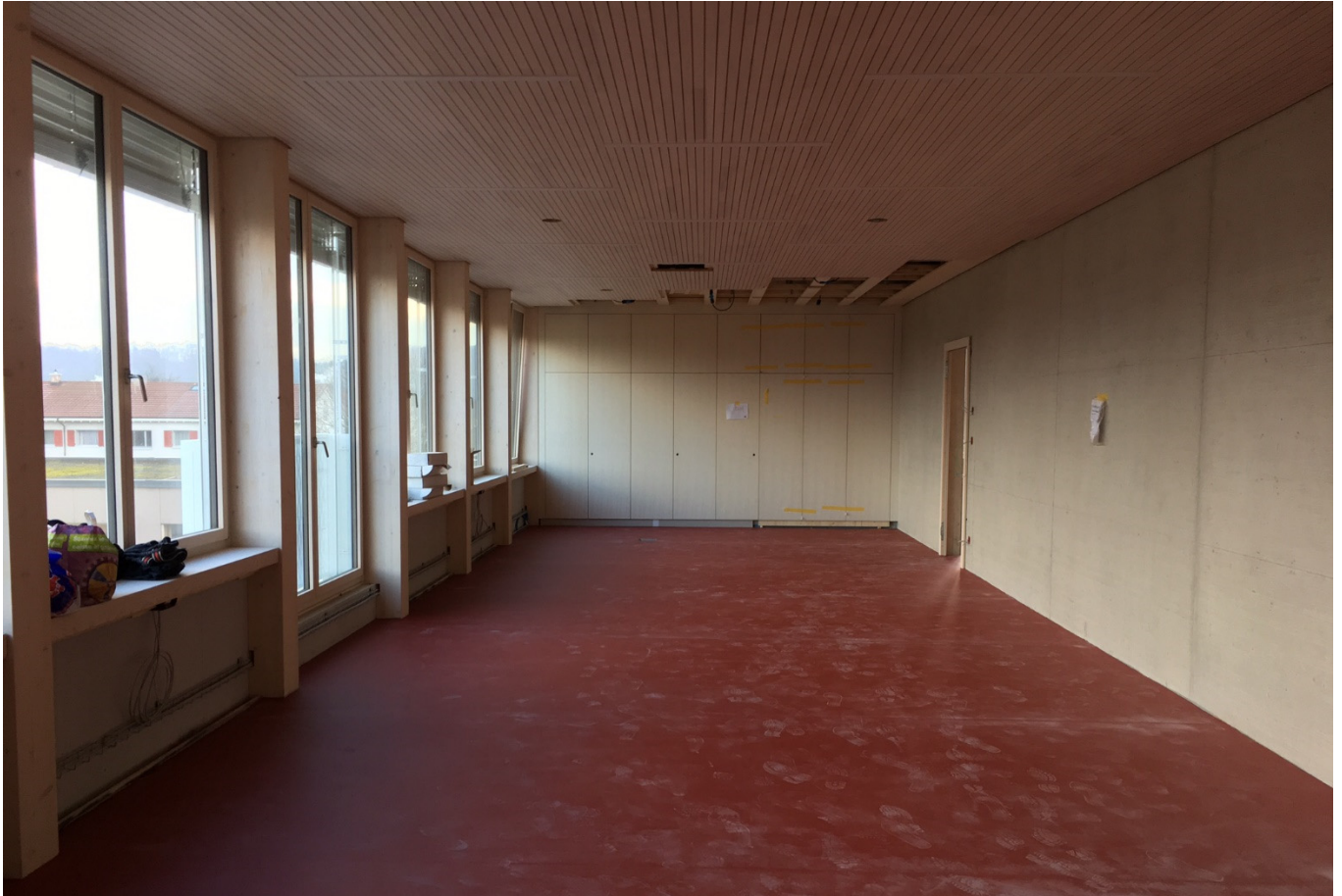
Schule, 2.OG, Boden-, Deckenbelag, Schrankfront und Fenstersims
